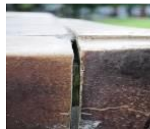
Fig. 4: mortelverlies aan de bovenkant, west-zijde
