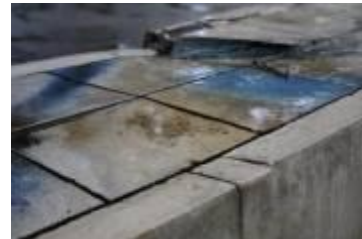
Fig. 7: plasvorming aan de bovenkant
