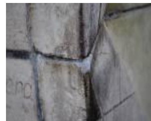
Fig. 5: witte uitslag van de mortel op de binnenzijde
